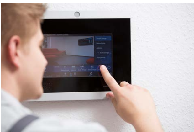
Abbildung 9: Integration eines KNX-Wandbediengerätes (Quelle: ZVEH)
