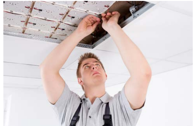
Abbildung 2: KNX-Deckeninstallation (Quelle: ZVEH)
