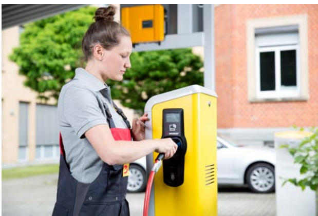
Abbildung 6: Überprüfen einer Ladesäule für Elektrofahrzeuge (Quelle: ZVEH)
